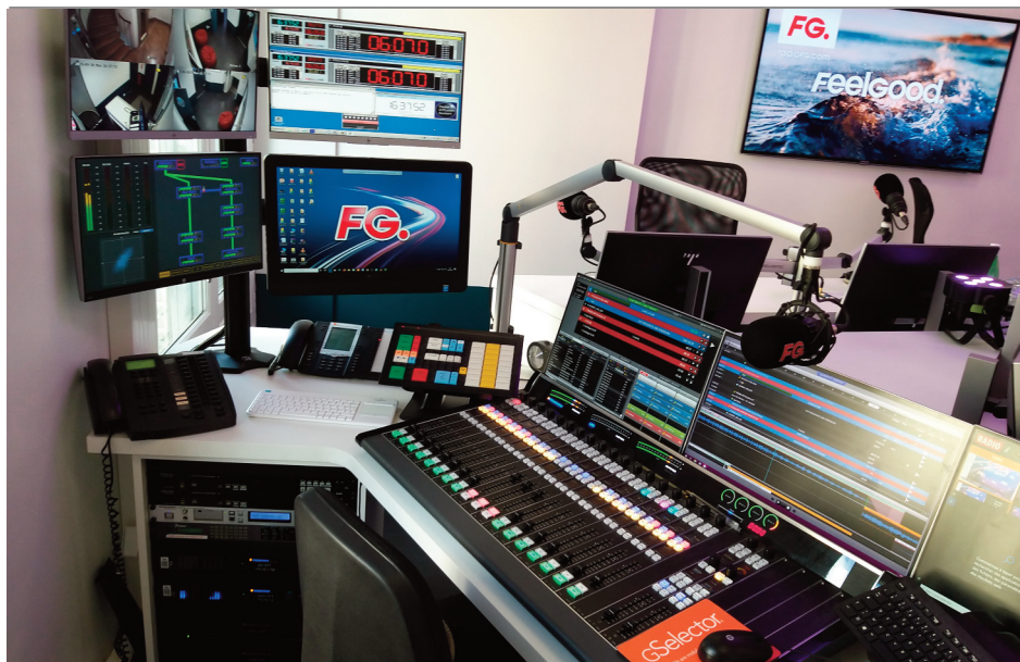
Studio principal Radio FG, avec la console LXE Wheatstone et sur les écrans (de gauche à droite) : une interface graphique Wheatstone sur mesure, Netcom pub, RCS Zetta double écran, Multicam Systems. Photo Sylvain Ferey, Radio FG
