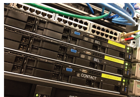
Les serveurs Playbox du CastLan en salle technique, avec le switch accueillant les flux audio Ravenna. © Thierry Peters
