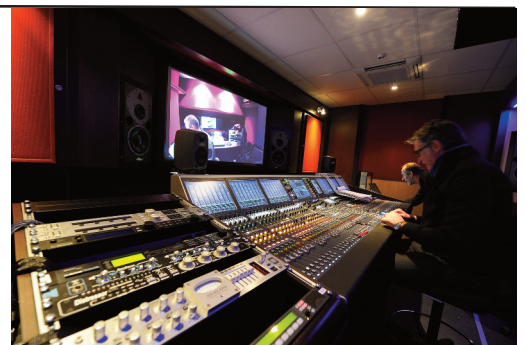
La régie embarquée a les mêmes capacités que celle des studios de la Maison de la Radio. © Radio France/Christophe Abramowitz
